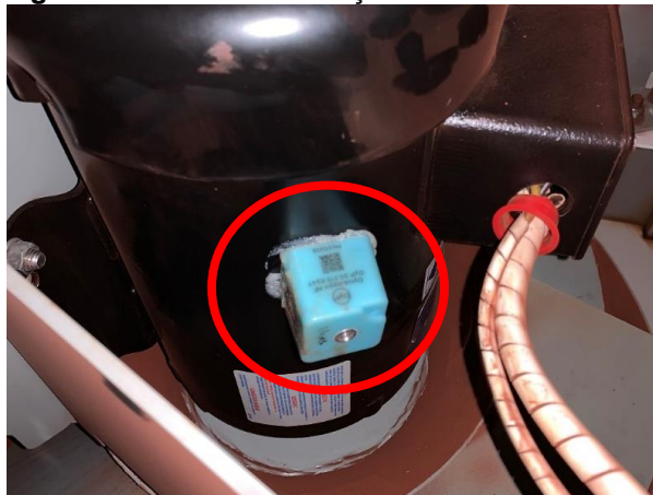
Figura 6 – Local de instalação do sensor
